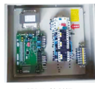
653# 控制柜 Control Cabinet
