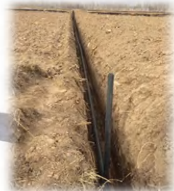
主管地埋 main pipe underground
