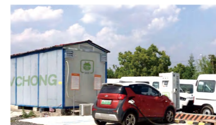
非洲光伏储能项目 A solar energy storage project in Africa
