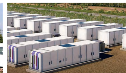
美国德克萨斯州光伏储能项目200MWh A solar energy storage project of 200 MWh in Texas, U.S.
