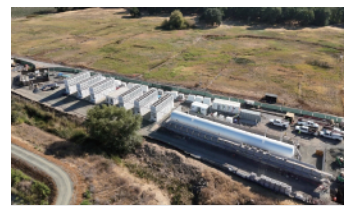
美国加利福尼亚州 12MWh长时储能系统
