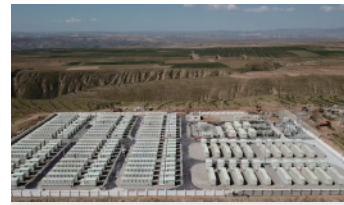
中国宁夏 宁夏最大的共享储能项目200MWh/400MWh
