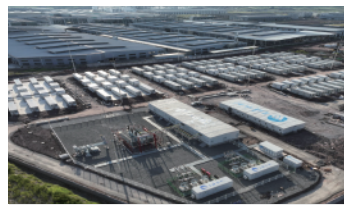
中国重庆 独立储能项目400MWh
