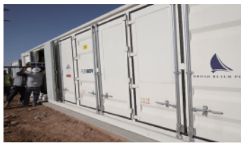
美国加利福尼亚州 级联式储能系统 117.5MWh
