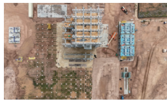
美国德克萨斯州 项目在建65MWh, 客户体验中心130MWh
