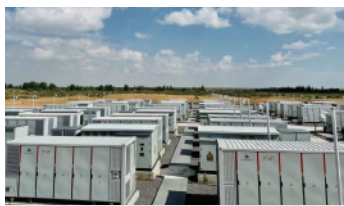
中国宁夏 首批大规模液冷储能系统项目100MWh/200MWh
