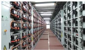
印尼莫罗瓦利工业园 (IMIP) 电网电力调节150MWh
