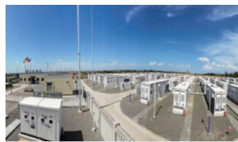
中国宁夏中卫 宣和项目150MWh/300MWh
