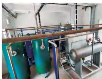
制药公司新建400t/d污水处理项目 New 400t/d sewage treatment project of pharmaceutical company
