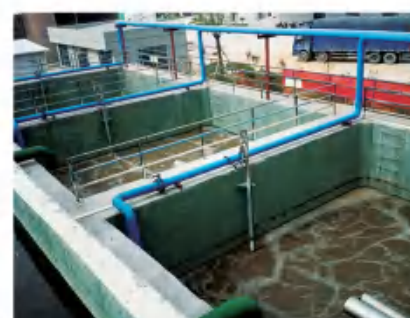
900m³/h 脱硫废水处理项目 900m³/h Desulfurization wastewater treatment project
