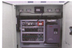
PLC自动控制系统
