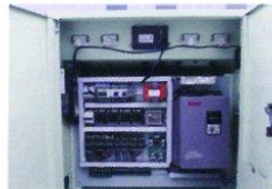
PLC自动控制系统
