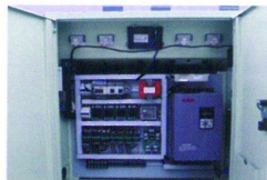
PLC自动控制系统
